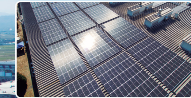
多数の太陽光発電パネルが稼働している 埼玉県本庄市の本庄第1~3工場
