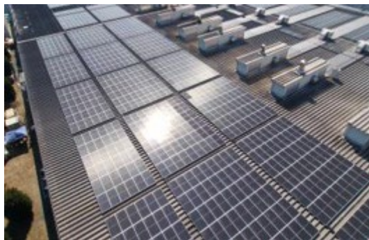
3万坪の工場に太陽光パネルを設置し、電力使用量の10%弱が再生可能エネルギーに
